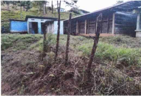
Foto 3: Circulación de establecimiento deteriorada y que necesita ser remozada con muro perimetral para mejor cuidado a los niños.
