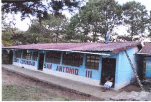
Foto1: Vista frontal de establecimiento donde se puede notar la necesidad de colocar balcones al establecimiento para una mayor seguridad del mismo.
