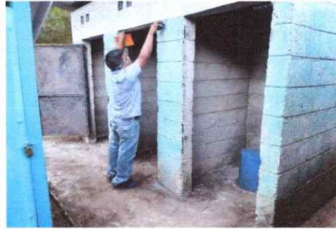
Foto 4: Imagen de sanitarios con necesidad de colocacion de puertas de metal.
